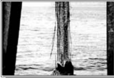
شکل ۳- خوردگی مجدد ستون ترمیم شده.
