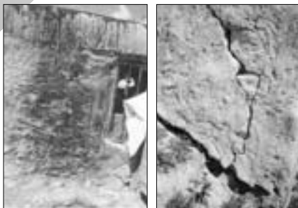
شکل ۳) ترکهای کششی دیوار ساختمانی مسکونی در اثر زمین لغزش
