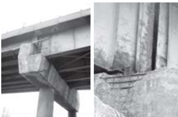
شکل ۱۳ - نمونه هایی از سطح خرابی S۱ در شاهتیرهای فلزی
