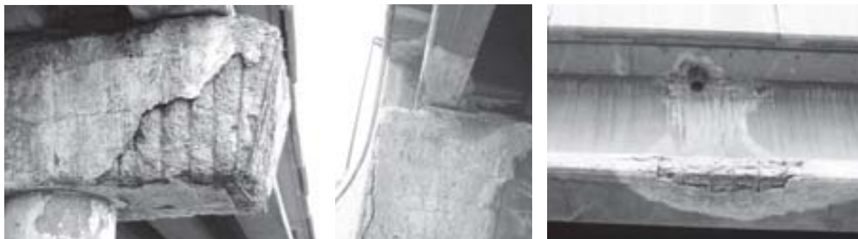
شکل ۱۲ - نمونه هایی از سطح خرابی C۴ در شاهتیرها و کوله و سرستون های بتنی پل کلاک
